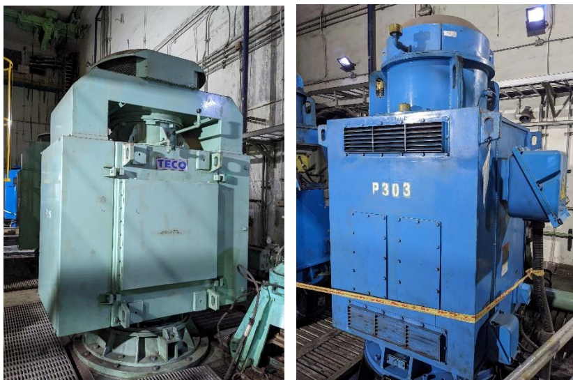
圖 1 進流抽水站原污水大型抽水泵(以中區廠為例)
