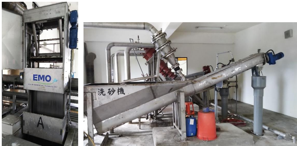
圖 3 機械攔污柵及洗砂機(以福田廠為例)
